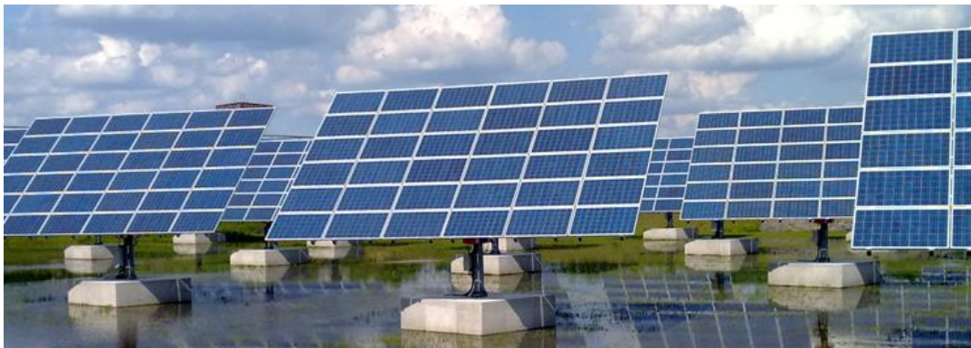
Abbildung 51: PV-Anlage auf einem Regenrückhaltebecken in Weiterstadt.
