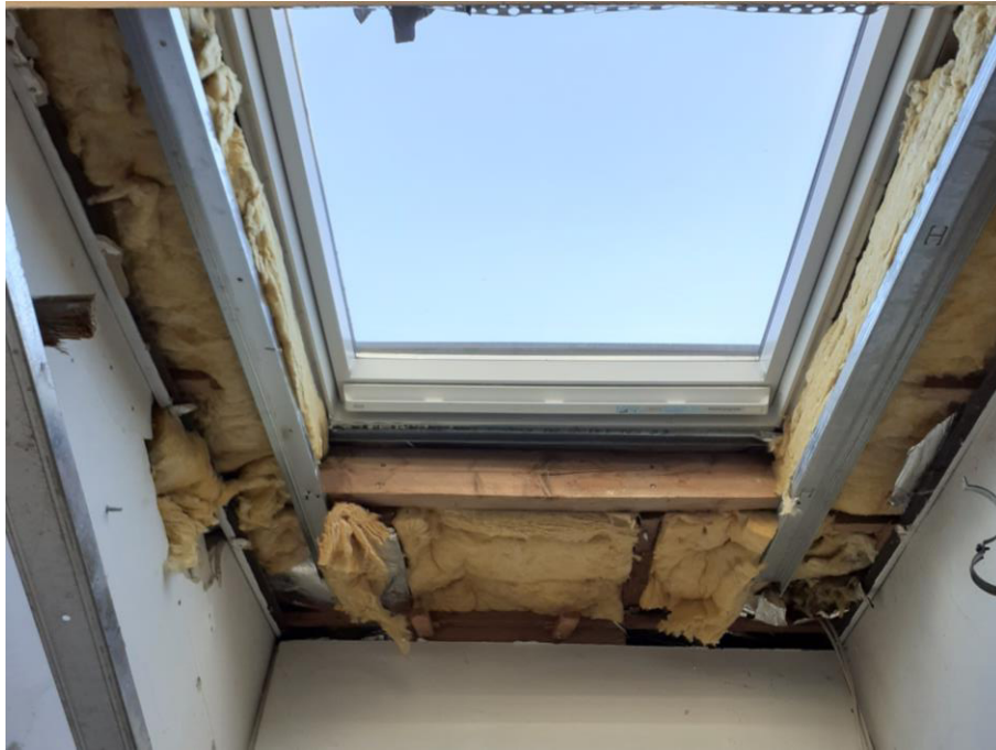
Schäden im Dachbereich
